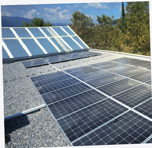
Autoproduction photovoltaïque sur les toits de la médiathèque et de l'école maternelle Aimé Legall
